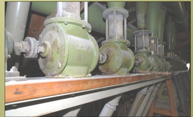
Des circuits à air comprimé transportent les produits
